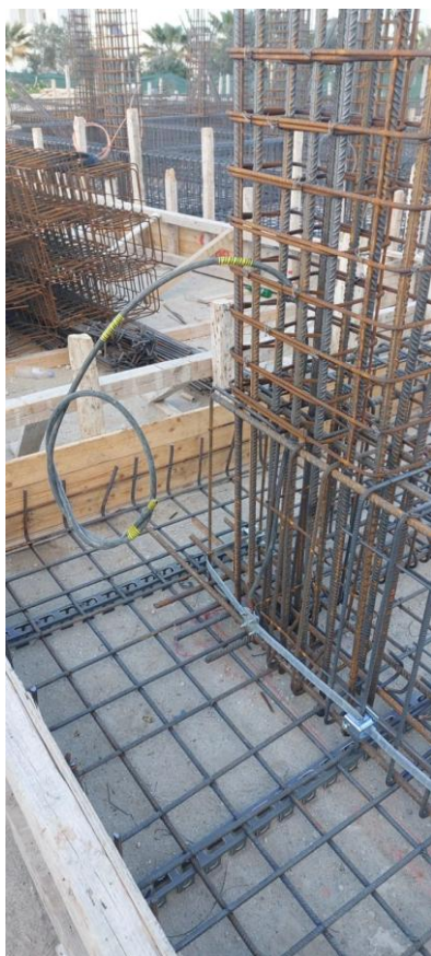
Φωτογραφία 6. Αναμονή μονωμένου χάλκινου αγωγού 50 mm 2 σε οπλισμένη θεμελίωση. Στη βάση του υποστρώματος διακρίνονται γαλβανισμένη ταινία και σφιγκτήρες· η ακριβής σύνδεση του αγωγού με την ταινία δεν φαίνεται στη λήψη.
